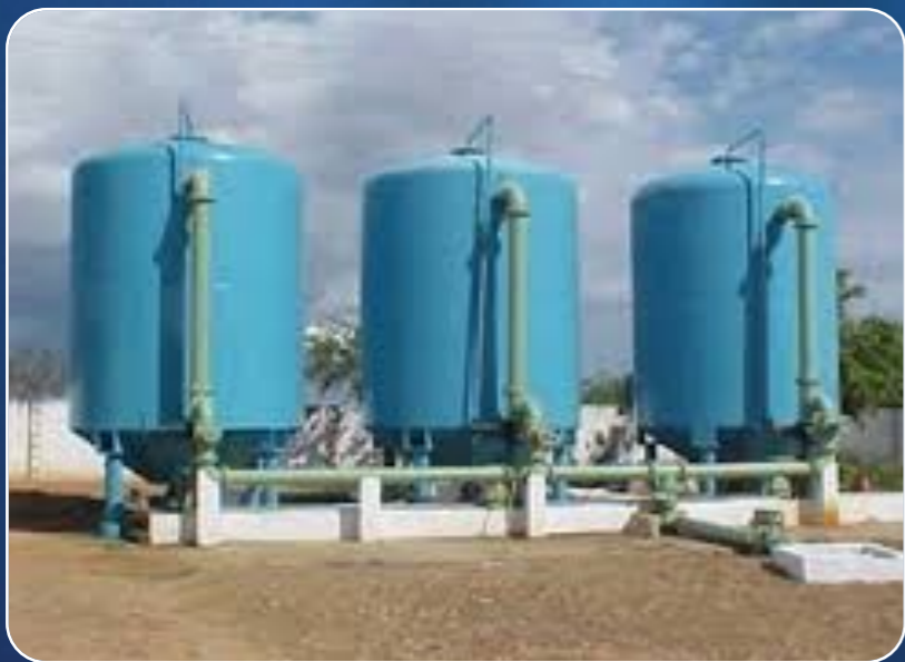
Tratamento de água
